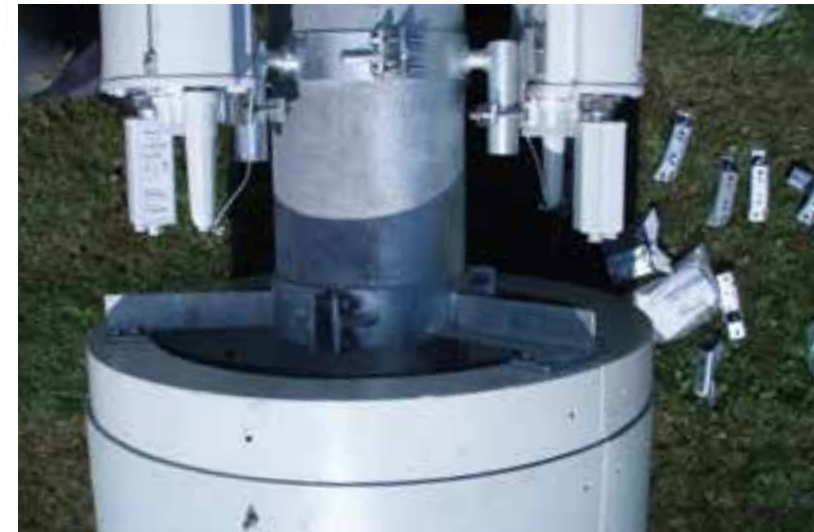
Panelantennener og link skjules af styrenplader. Der er plads til fire operatører i masten.
