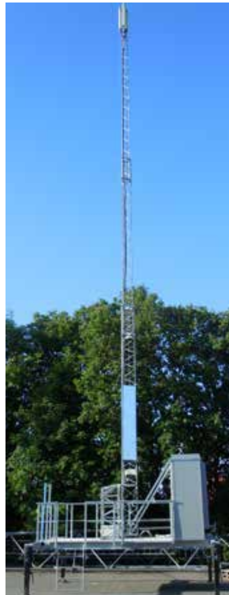
Denne teleskopmast anvendes til telekommunikation. Enheden flyttes med lastbil til site for at dække et midlertidig behov på op til et år.
