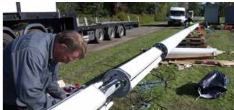
Ovenstående flagstang er for to operatører. Der anvendes standard panelantennener, som skjules af en polystyren inddækning.
