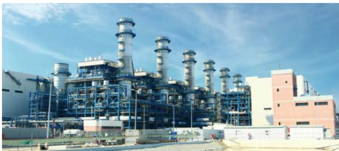
HRSG Boiler (Heat Recovery Steam Generator)
