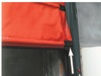
... ce qui n'empêche pas la remontée du tablier...
