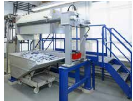
Filterpresse zur Abwasserbehandlung
