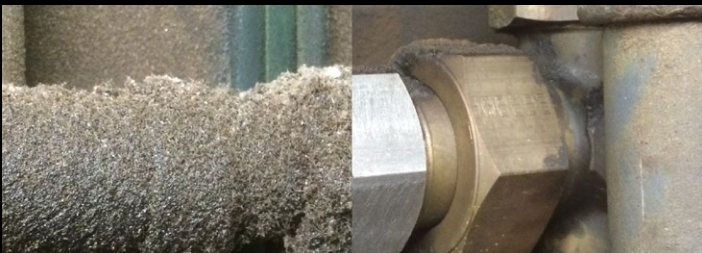
Dieses Bild zeigt einen Staubpelz, der sich auf einem fettigen Rohr gebildet hat. Während Verfahren mit konventionellen Reinigungsmitteln nicht nur sehr aufwendig und ineffizient sind, sondern auch belastete Abwässer erzeugen, lässt das Trockeneisstrahlverfahren Staub und Fett einfach abplatzen.
