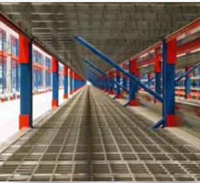
Hyllor Våra näthyllplan är kraftfulla och konstruerat av stål nät vilket ger ett bra genomsläpp av ljus och vatten från exempelvis ett sprinklersystem.
