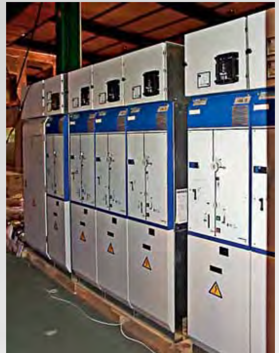
ABB Substation - SCHWEIZ - ORMAZABAL - CGM 24kV, 630A 8 fack
