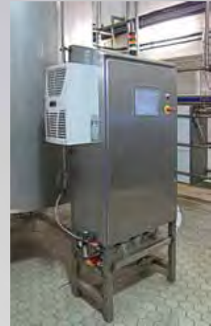
CHI - Tetra Pak - NIGERIA - Automatisk skåp med PLC installerat
