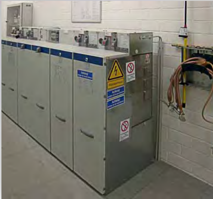
Ikea Rostock - TYSKLAND - ORMAZABAL GAE 630 MSP 12kV installerat
