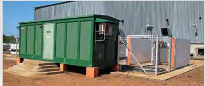
EDM - MOZAMBIQUE - Gaskälla med SEBAB inomhusstation 33kV
