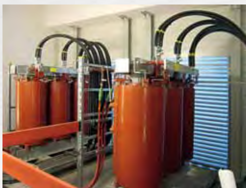
Ikea Rostock - TYSKLAND - Trafo TESAR 2x1600kVa
