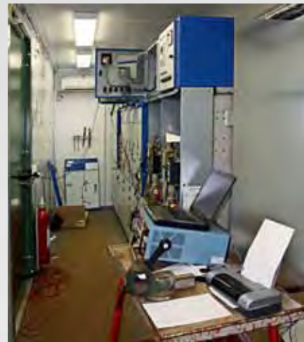
EDM, Mozambique Drift-relättest av station 33kV
