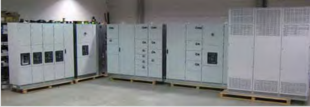
Flygkök ETHIOPIA - ELCOVER LSP 5000A med transformator kapsling.
