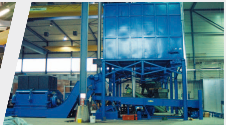
ZENO-Folienzerkleinerungs- und Aufbereitungsanlage
