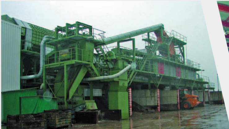
Vollautomatische ZENO-Bauschutt- und Gewerbemüllsortieranlage
