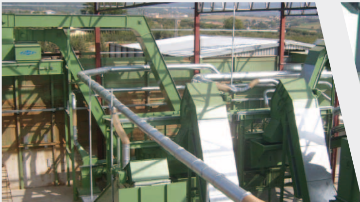
ZENO-Restholaufbereitung mit Vor- und Nachzerkleinerung
