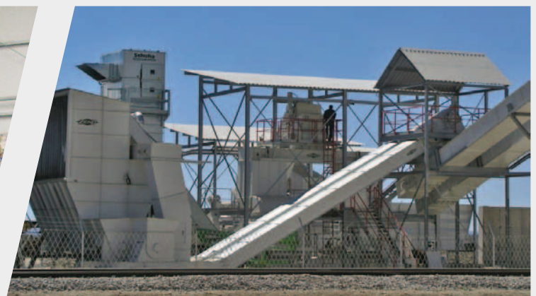
ZENO-Ersatzbrennstoffaufbereitung im Zementwerk
