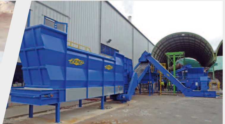
ZENO-Brennstoffaufbereitungsanlage für Spuckstoffe und Zöpfe
