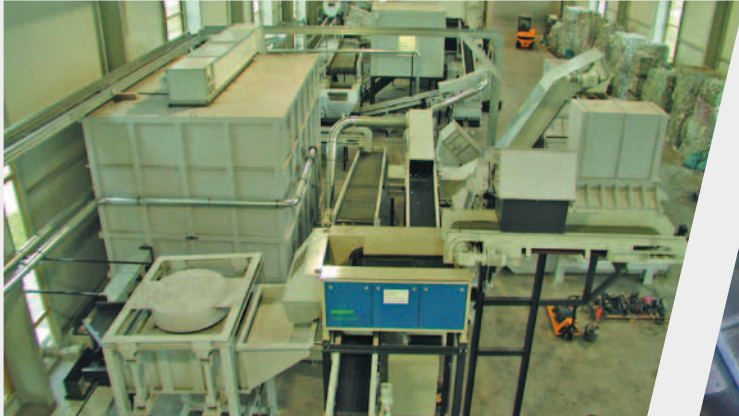
ZENO-Wertstoffaufbereitungsanlage zur Edelmetallgewinnung
