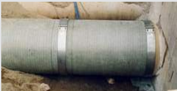
INKOPPLINGSRÖRDEL MOT BETONGBRUNN
