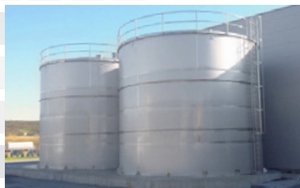
Zbiorniki wolnostojące zewnętrzne o pojemności do 1 mln litrów
