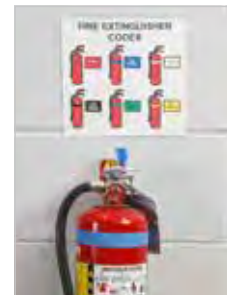
Skapa tydlig brand-släckarinformation.
