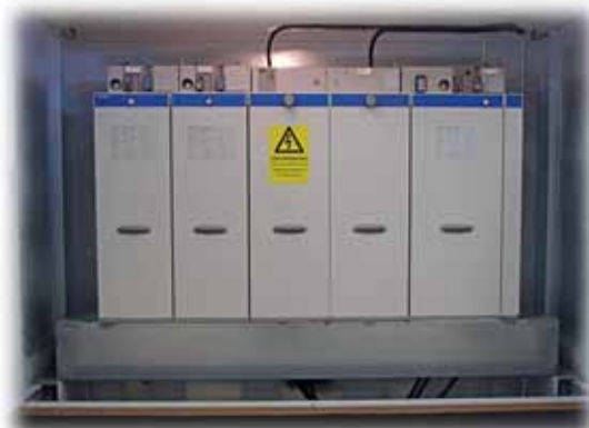
GA630 MS-Ställverk i nätstation.
